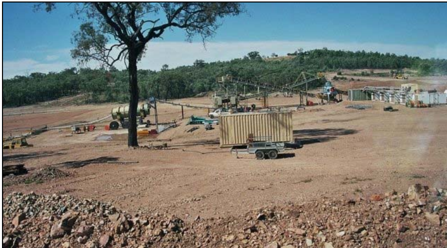
Crushercircuit mit Generatoreinheit (rechts)
