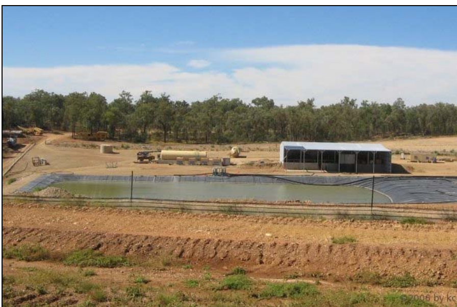
eines der Becken, die elektrische Gewinnungsanlage, links daneben der Generator mit Dieselbehälter
